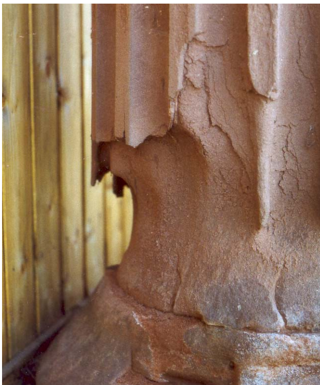
Abb.18: Verwitterung mit Salz-Ausblühungen an Säulenfuß
