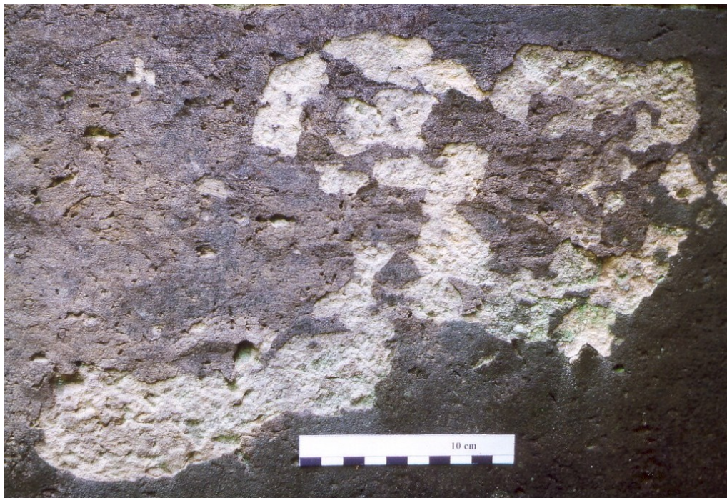
Abb.1: Dünne Schalen an einem unbehandelten Cottaer Sandstein
